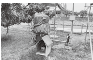
散水に使うポンプ
