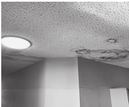
雨漏り箇所の様子
