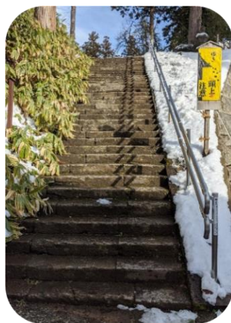
本堂から三重塔への階段に設置された手摺
