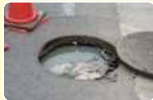
▲油脂が固まりマンホールが詰まると汚水が溢れ出し、非常に不衛生になります。
