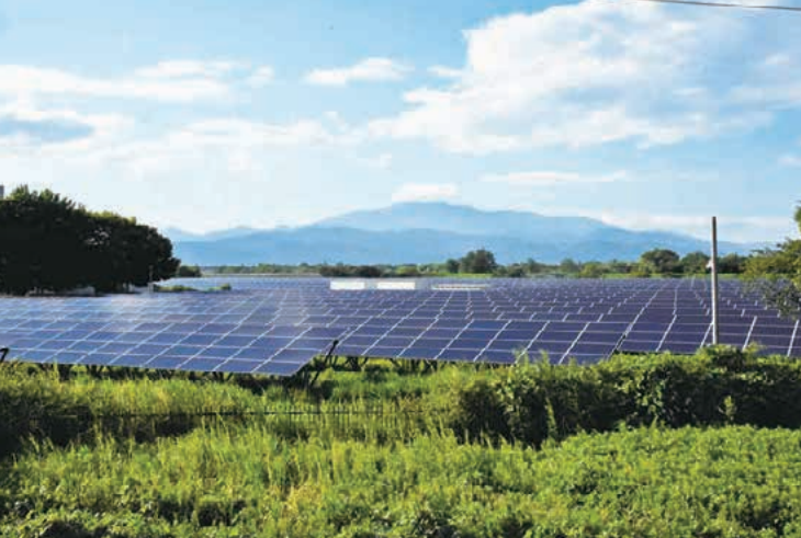
浄化センター内の太陽光パネル
