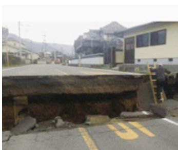
地震の爪痕（2mの段差）
