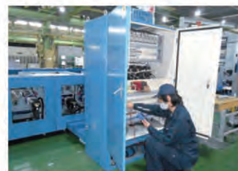
製品配電盤内の通電確認作業
