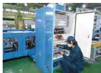
製品配電盤内の通電確認作業
