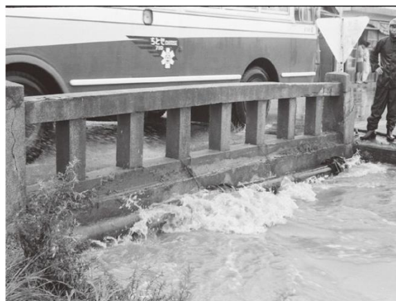
河北町・橋の桁下まで増水した河川
