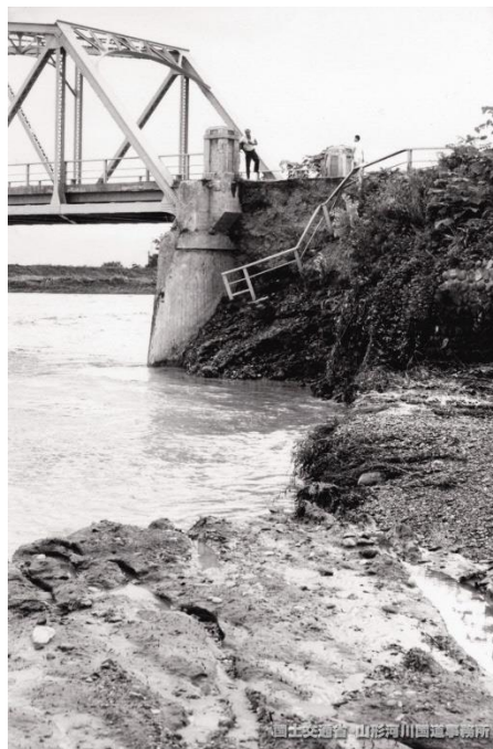
中山町・国道112号長崎橋橋台流出
