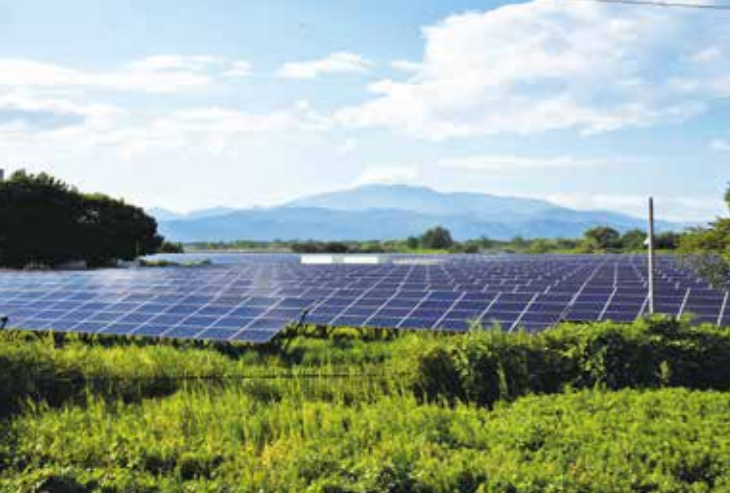
浄化センター内の太陽光パネル
